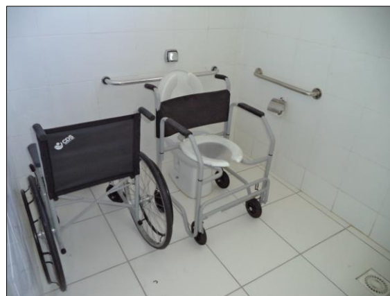
Figura 32 – Banheiro adaptado Fonte: A autora, 2018.
