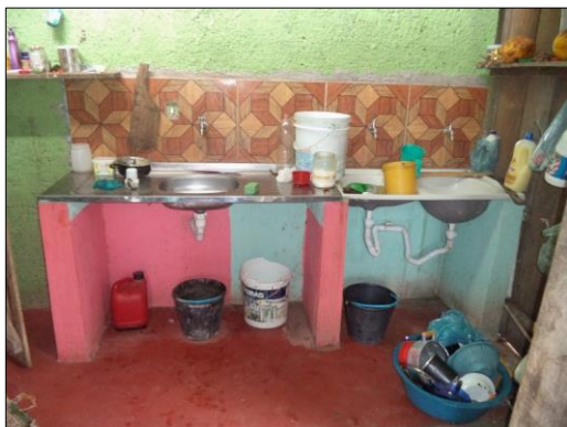
Figura 75 – Pia sem sifão Fonte: A autora, 2018.
