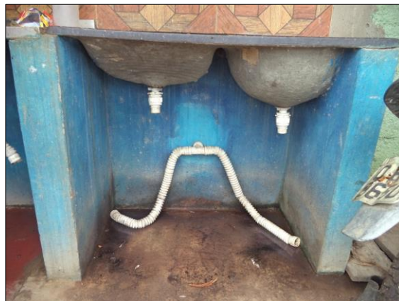
Figura 74 – Sifão danificado Fonte: A autora, 2018.
