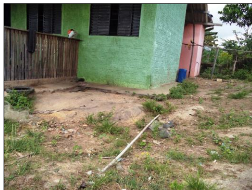
Figura 76 – Tubulação desprotegida Fonte: A autora, 2018.
