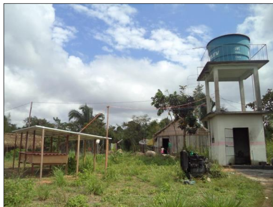
Figura 48 – Painel fotovoltaico e reservatório do sistema de abastecimento de água Fonte: A autora, 2018.
