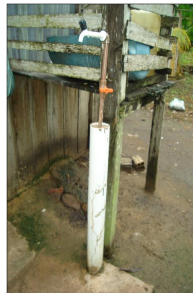
Figura 42 – Torneira disposta ao lado da casa
